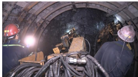
Hình 1: Xe khoan tự hành 2 cần tại gương đào Công ty Than Nam Mẫu - TKV
