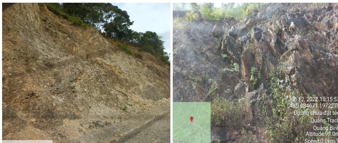
Hình 4. Đá bị vỡ vụn, nứt nẻ
