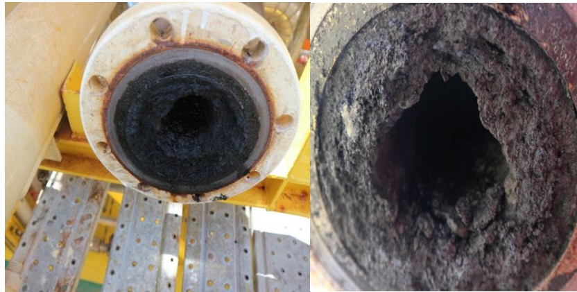
Hình 2: Hình ảnh tuyến ống vận chuyển nước khai thác bị scaling.
