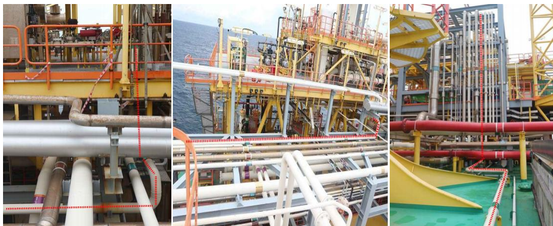
Hình 8: Hình ảnh tuyến ống nước khai thác cũ
