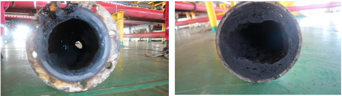
Hình 5: Hình ảnh tuyến ống xử lý nước khai thác bị scaling.
