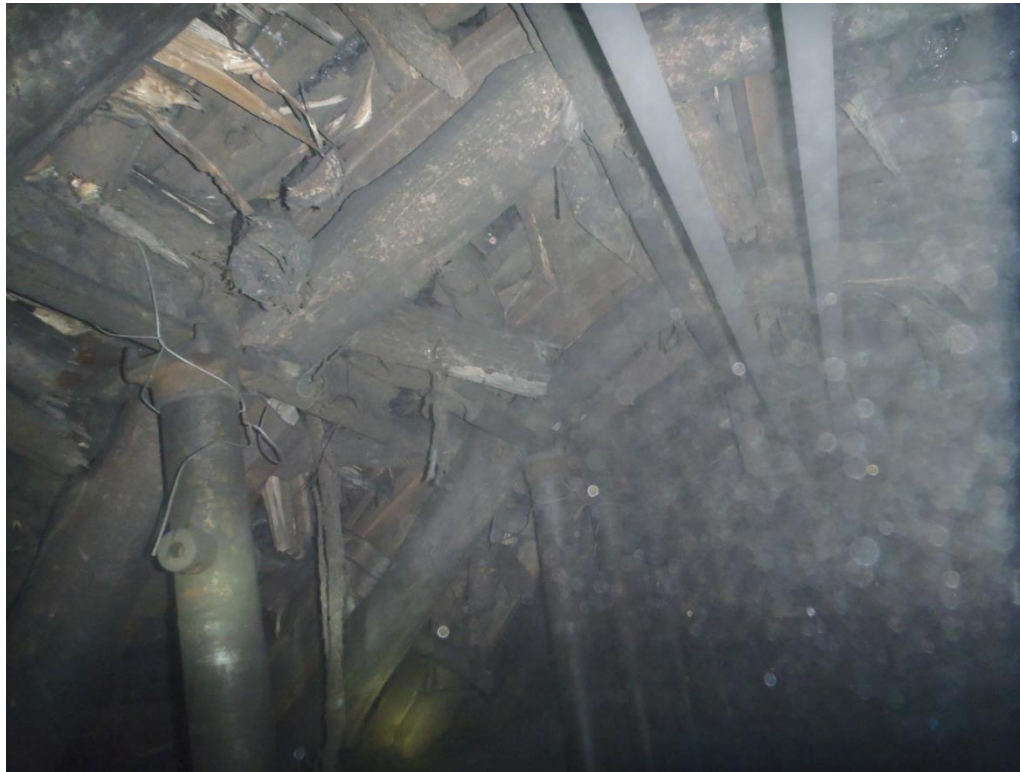
Hình 3: Hiện tượng phá huỷ khung chống tại mỏ than Mạo Khê
