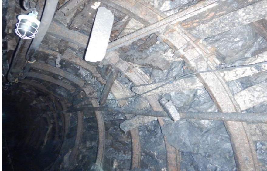
Hình 15: Hiện tượng gập khung chống đường lò
