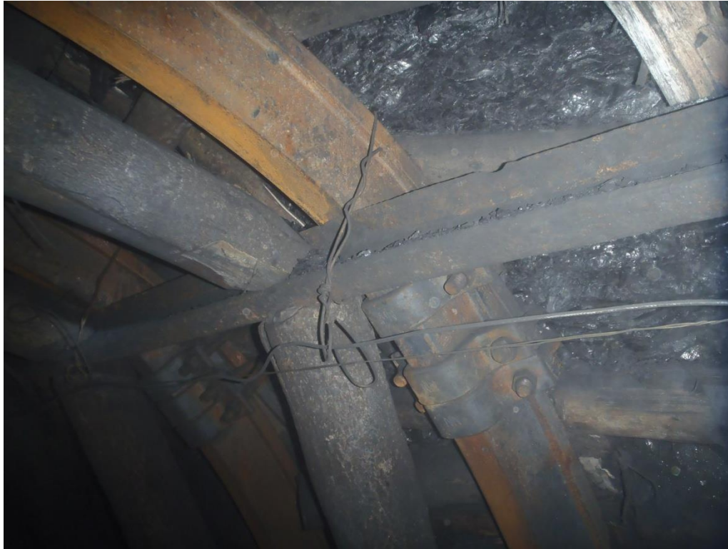
Hình 4: Hiện tượng phá huỷ khung chống tại mỏ than Mạo Khê
