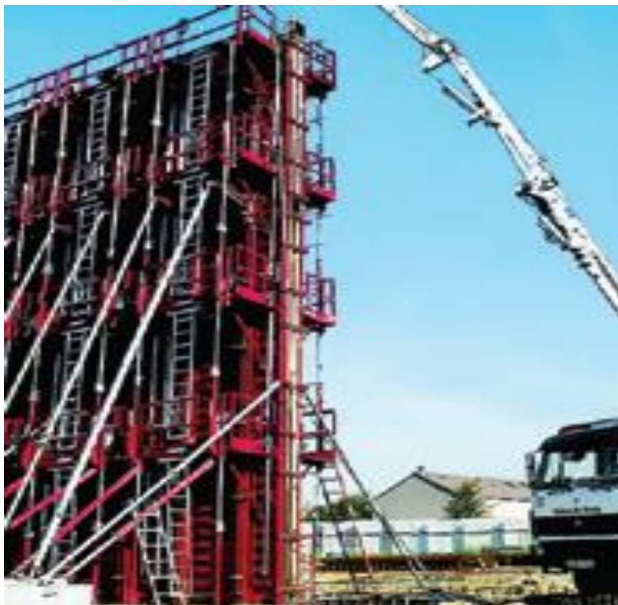
Hình 3.1 Chống đỡ vách phục vụ cho giải pháp bơm bê tông từ trên xuống
