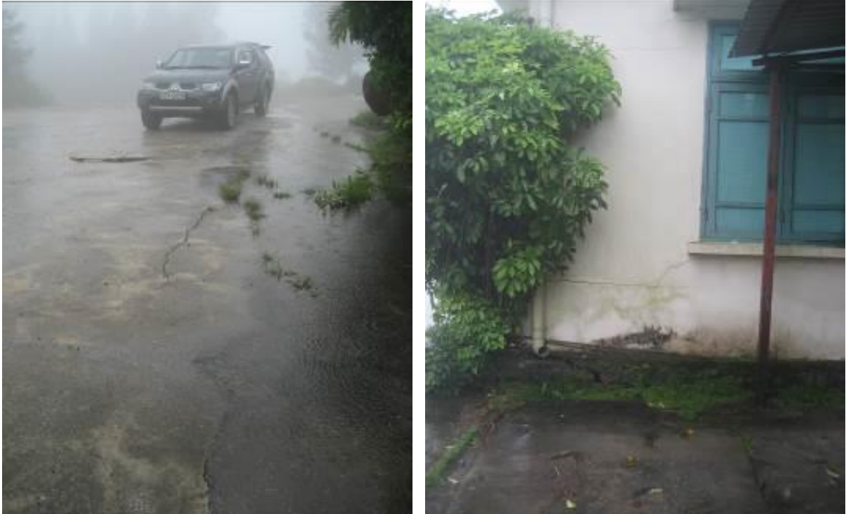
Hình 3.1: Các khe nứt trượt kéo theo (thứ cấp) xuất hiện tại sân và góc nhà điều hành ở cao trình +284m.
