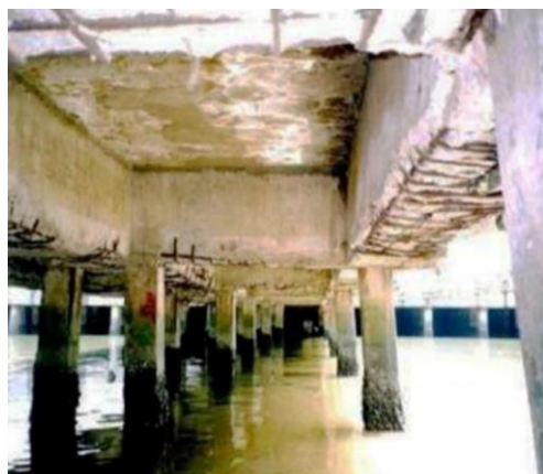
Hình 2. Ăn mòn kết cấu bê tông cốt thép tại các cảng biển ở Việt Nam
