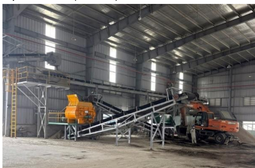
Hình 6. Hệ thống máy trộn trực vít
