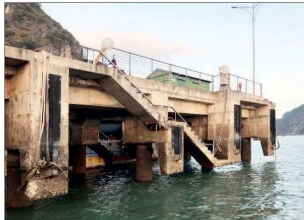
Рис. 3. Разрушение пирса в заливе Халонг (Вьетнам) Fig. 3. Destruction of the pier in Halong Bay (Vietnam)
