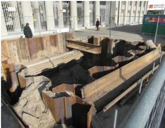
Hình 3. Bảo vệ thành hố đào bằng cừ ván thép tại công trường xây dựng tuyến 2 metro Vácava – Balan [5]
