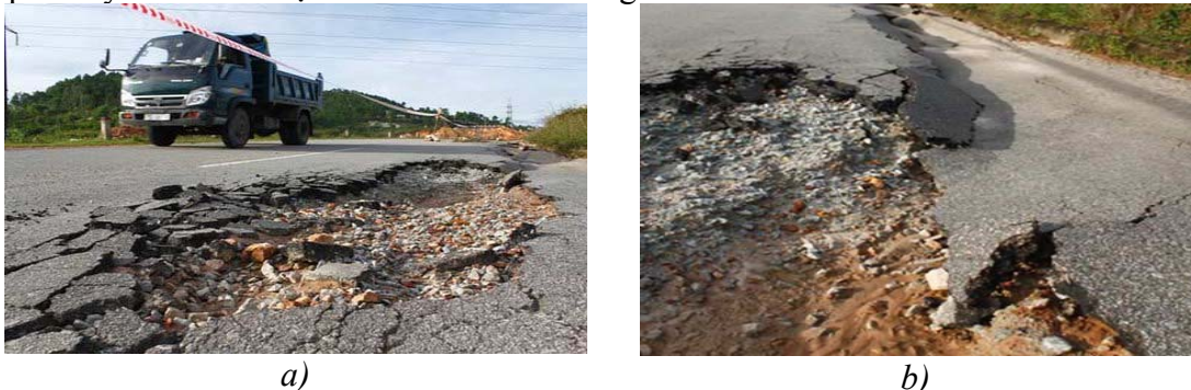
Hình 3.3. Lún sụt đoạn đường tránh nối QL 1A với quốc lộ 49 gây phá hủy nền mặt đường (Nguồn Internet). a) trượt trôi gây nên hiện tượng mấp mô; b) trượt trôi sâu gây mất một phần của nền đường
