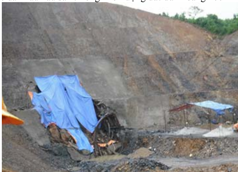
Hình 6. Sự cố sập lở cửa hầm tunnel Ngàn Trươi-Cẩm Trang, Hà Tĩnh
