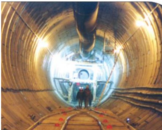
a) Vỏ chống đúc sẵn cho đường hầm xây dựng dưới sông St. Clair giữa Sarnia, Ontario và Port Huron, Michigan, Hoa Kỳ [4]
