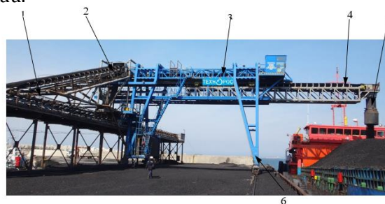
Hình 2. Hệ thống rớt than di động xuống tàu tại cảng
