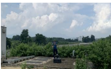
Trạm biến áp 500 kV tỉnh Sơn La
