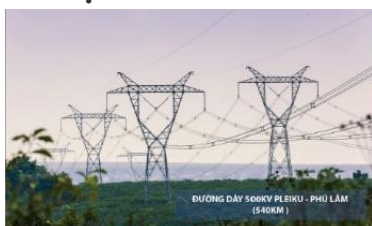
Đường dây tải điện 500 kV các tuyến: Bắc - Nam Quảng Trạch, Sơn Lam, Hòa Bình, Ninh Bình, ...
