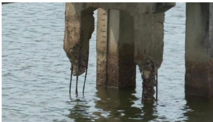
Рис. 5. Железобетонные конструкции подвергаются коррозии под воздействием приливов и отливов (Нго Суан Хунг, 2022) [18]
