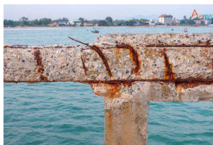
Рис. 1. Железобетонные конструкции, морские сооружения, подверженные коррозии
