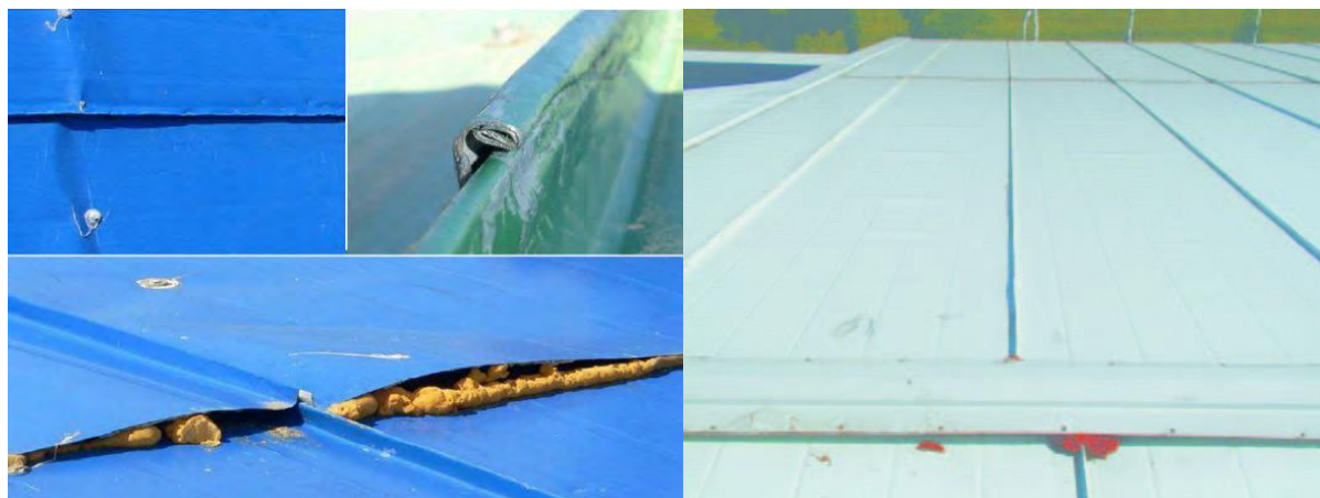
Рисунок 1. Деформации кровли из сэндвич-панелей
