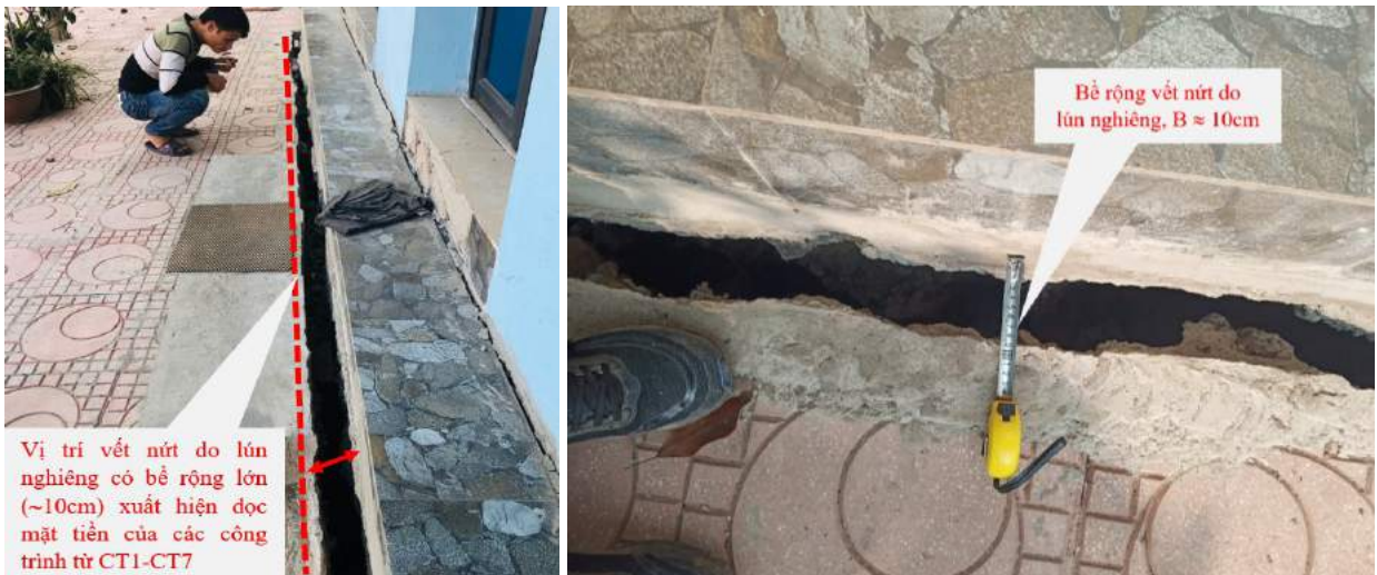
Hình 6. Vết nứt kéo dài với bề rộng lớn các mặt tiền của các công trình trong phạm vi nghiên cứu.
