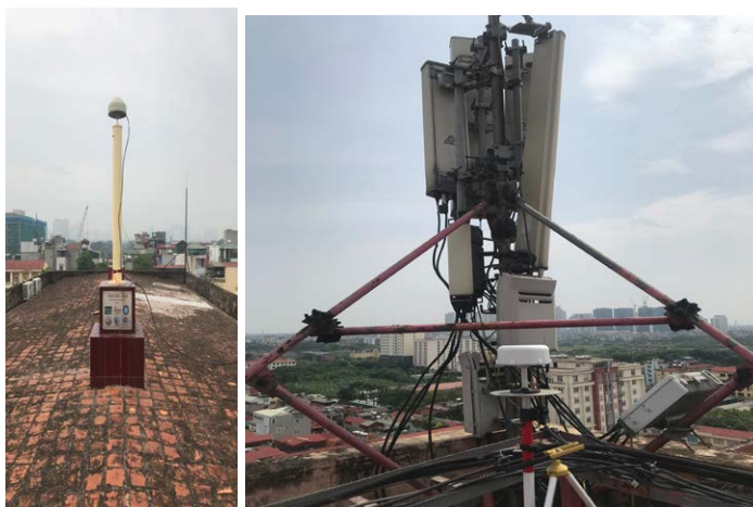
Hình 6: Thiết bị sử dụng thử nghiệm với trạm cơ sở và trạm quan trắc
