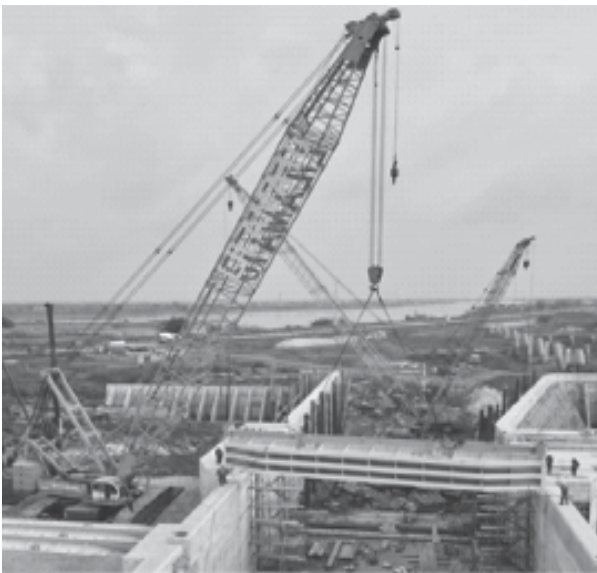
Cán bộ, công nhân viên Công ty Cổ phần LILAMA 10 thi công tại dự án với mục tiêu an toàn, chất lượng và tiến độ.
