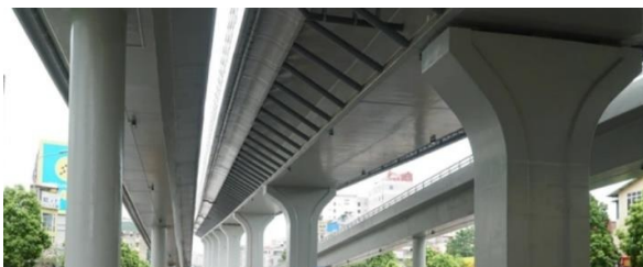
Hình 1. Thanh chống thép tăng khả năng chịu lực cho bản cánh dầm hộp trên đường Trường Chinh, tuyến Vành Đai 2, thành phố Hà Nội.
