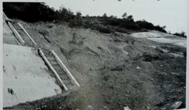
Hình 1: Hình ảnh mảng bê tông lớn được phun phủ bị nứt toác rồi trượt xuống mặt đường
