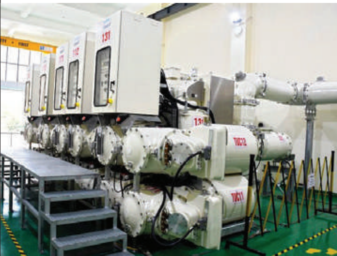
Hệ thống thiết bị đóng cắt hợp bộ (GIS) được điều khiển từ xa
