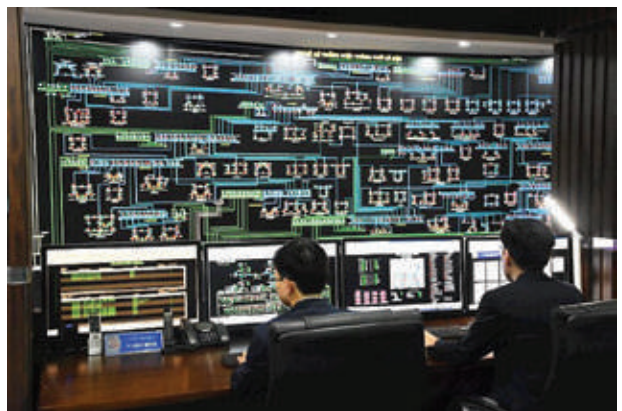
Hệ thống điều hành SCADA việc chỉ huy, thao tác vận hành, đóng cắt thiết bị từ xa
