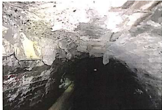
b) Phá hủy vỏ bê tông lưu vì tai đường lò 17.2 do ảnh hưởng của nước chảy từ bãi thải khu bãi thải mỏ Tân Lập - Công ty than Hạ Long - TKV
