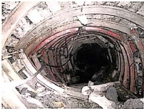
a) Đường lò xuyên vỉa +17 vị trí PK 348 bị nén lún do áp lực bãi thải mỏ Tân Lập - Công ty than Hạ Long - TKV
