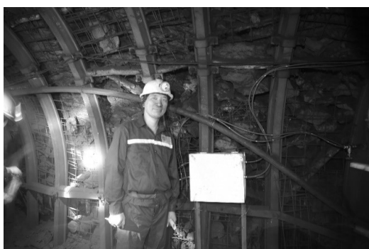
Hình 10. Hộp kỹ thuật đặt thiết bị lọc nước và lọc khí
