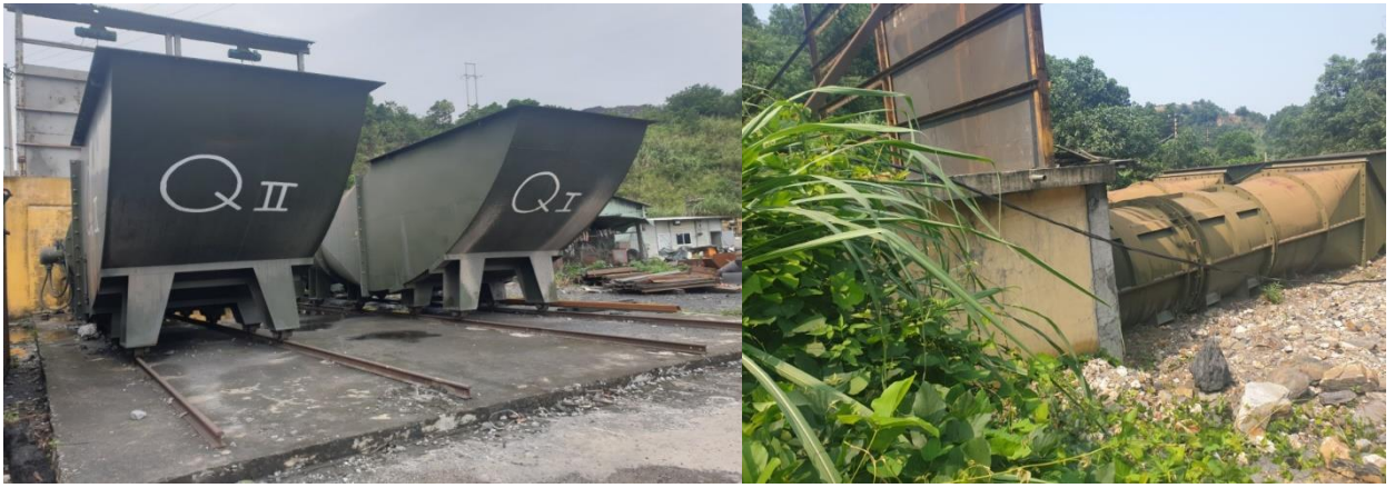
a). Hình ảnh trạm quạt FBDCZ-No27, mức +17 nhìn phía trước
