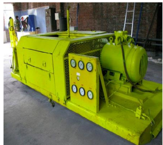
Hình 5. Trạm nén khí cao áp
