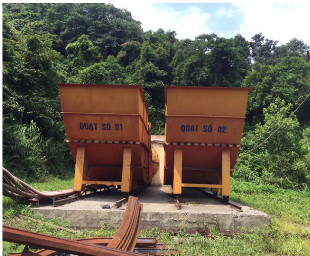
H.4. Hình ảnh của quạt FBCDZ-N 024 mức +340, khu Đồng Vông, Tân Dân, Công ty than Uông Bí-TKV
