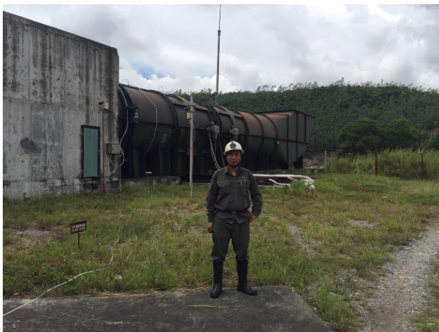
H.1. Hình ảnh bên ngoài trạm quạt FBCDZ-N 0 35 mức +120, mỏ than Mạo Khê
