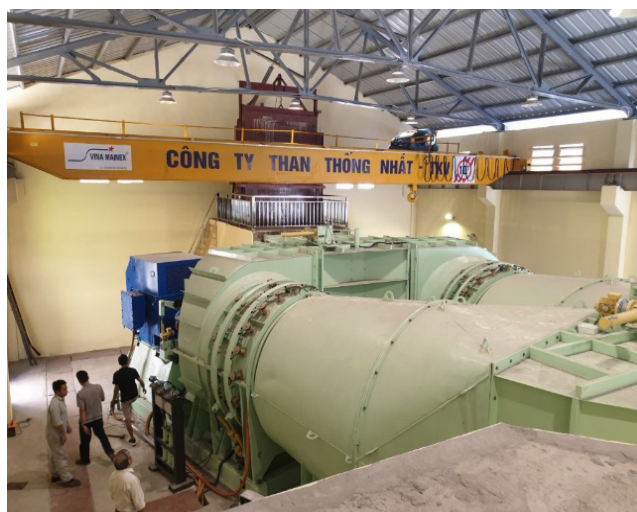
H.6. Trạm quạt VOV.22/14 AR, mỏ than Thống Nhất
