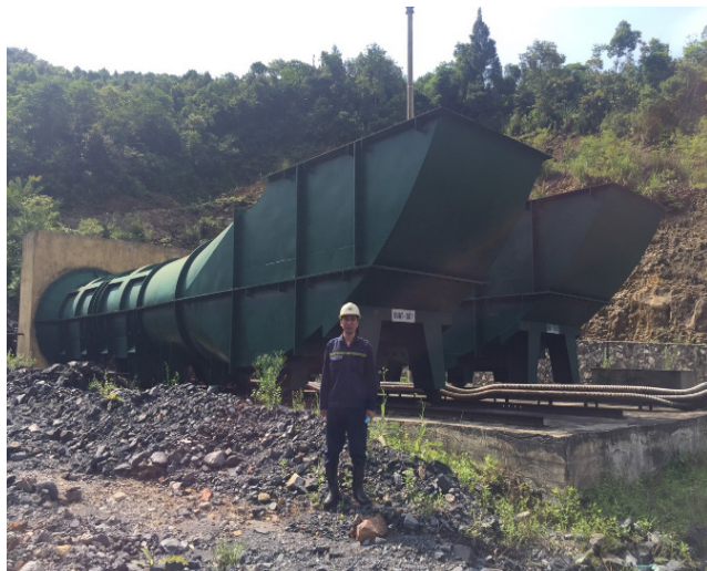
H.3. Hình ảnh của quạt FBCDZ-N 20 mức +320, khu Đồng Vông, Tân Dân, Công ty than Uông Bí-TKV
