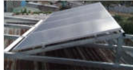
Hình 1. Hệ thống quang điện hòa lưới áp mái.
