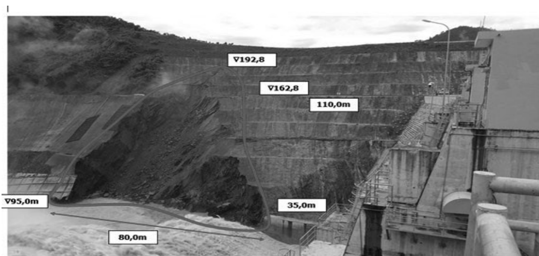
Hình 3. Hiện trạng mái đào bị sạt trượt (9/2018).
