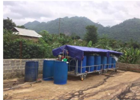
Hình 4. Modul hệ thống xử lý nước thải sản xuất cà phê tại tỉnh Sơn La
