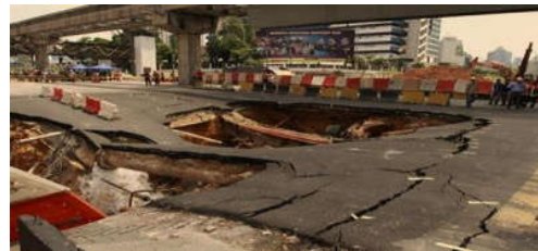
Hình 2. Sụt lún mặt đất khi thi công hầm ở Kuala Lumpur năm 2014
