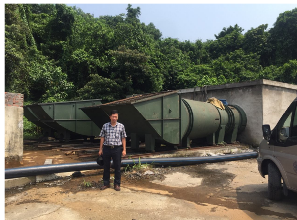
Hình 5. Hình ảnh chung trạm quạt FBDCZ- No14, mức +27 m
