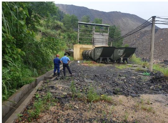
Hình 2. Hình ảnh chung trạm quạt FBDCZ- No22, mức +35 m
