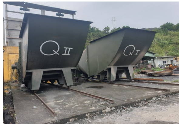
Hình 3. Hình ảnh chung trạm quạt FBDCZ-No27 mức +17 m
