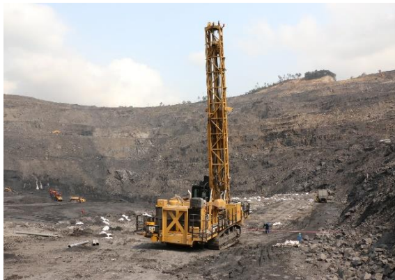
Hình 12. Máy khoan xoay cầu thủy lực CAT MD6250 của Công ty CP Than Cao Sơn.
