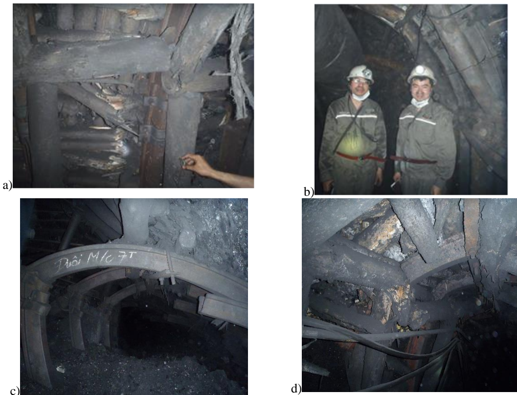
Hình 1. Một số biểu hiện phá hủy tại đường lò dọc vỉa -89 V6 mỏ than Mạo Khê (Ảnh chụp bởi nhóm tác giả thực hiện đề tài)
