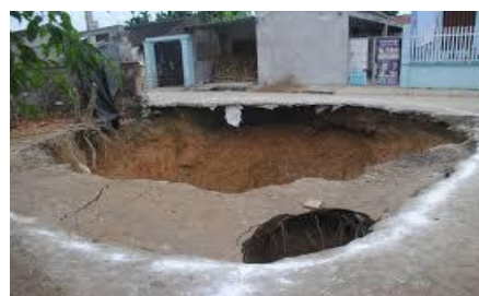
Sụt lún đường kính 1,5 m, sâu 3 m; xã Quý Lộc, h. Yên Định, Thanh Hóa
