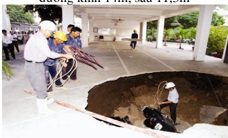
Sụt đất trong khuôn viên Sở Ngoại vụ TP. Hồ Chí Minh, năm 2008
