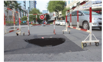
Hình 7. Hố tử thần trên đường Lê Thánh Tôn - Quận 1 ngày 12.6.2017
