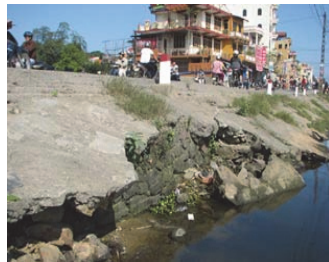
Hình 10. Sạt lở bờ kè tại quận 8
