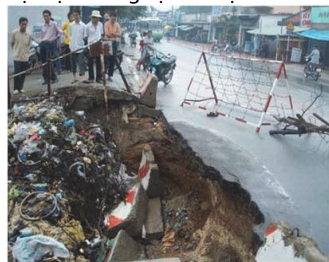
Hình 9. Đoạn đường sạt lở gần cống thoát nước trên tỉnh lộ 43
