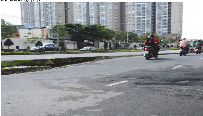
Hình 3. Mặt đường BTN Nguyễn Hữu Cảnh bị lún và bong tróc trong điều kiện nhiệt độ tăng cao. Do vậy, để mặt đường đảm bảo ổn định cần có những giải pháp tính toán thiết kế kết cấu mặt đường BTN phù hợp với điều kiện ĐKKH, góp phần nâng cao chất lượng khai thác và tăng tuổi thọ của mặt đường BTN.
