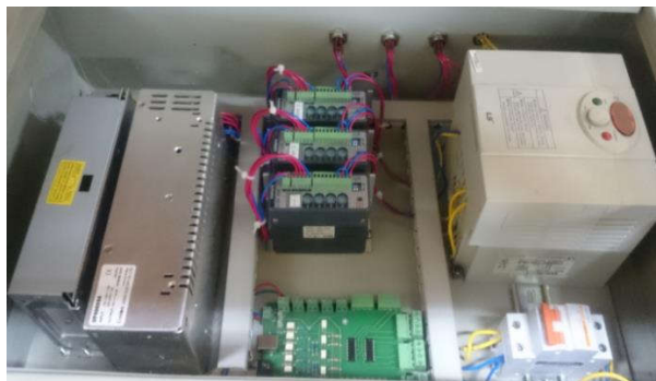
Hình 6. Các thiết bị trong tủ điều khiển máy CNC
