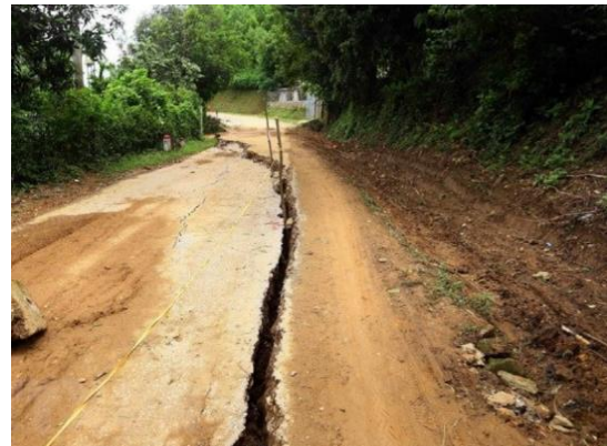
Ảnh 2. Đường tỉnh lộ 445 tại km3, bị nứt tại xóm Máy Giấy, xã Dân Hạ, Kỳ Sơn
