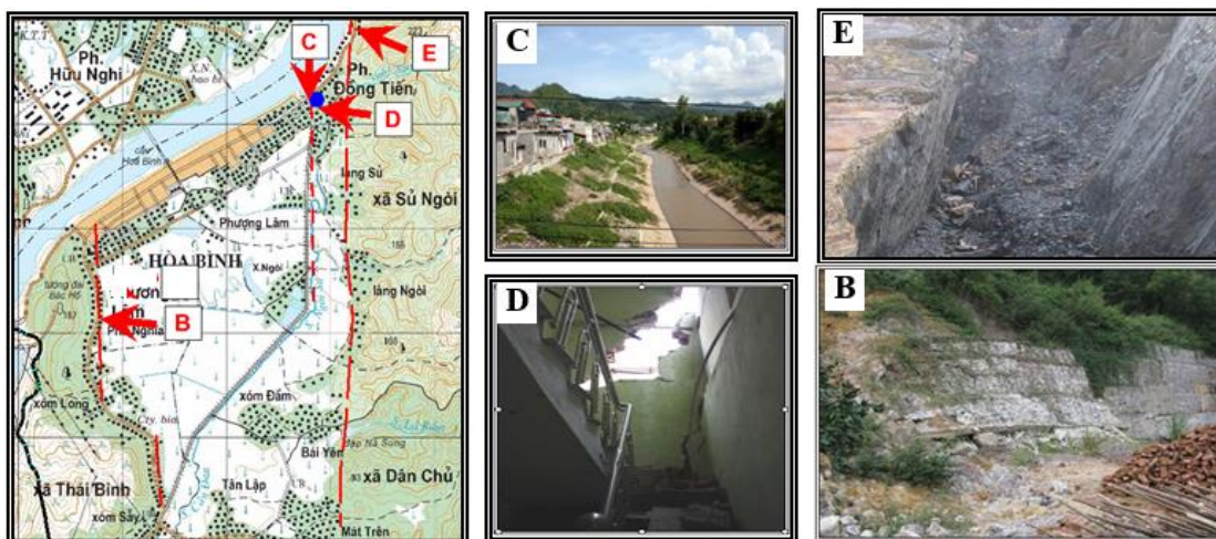
Hình 4. Khu vực phường Đông Tiến (Hòa Bình) C-Cửa suối Đen bị sạt lở nhiều lần và đã được kè đá (nằm dọc đứt gãy á kinh tuyến sườn Đông thành phố Hòa Bình); D-Tường nhà chị Liễu ở phường Đông Tiến bị nứt vỡ hư hại; E-Mặt trượt đứt gãy á kinh tuyến kéo từ chân núi lên đỉnh; B- Vách talus nhà dân đã kè đá
