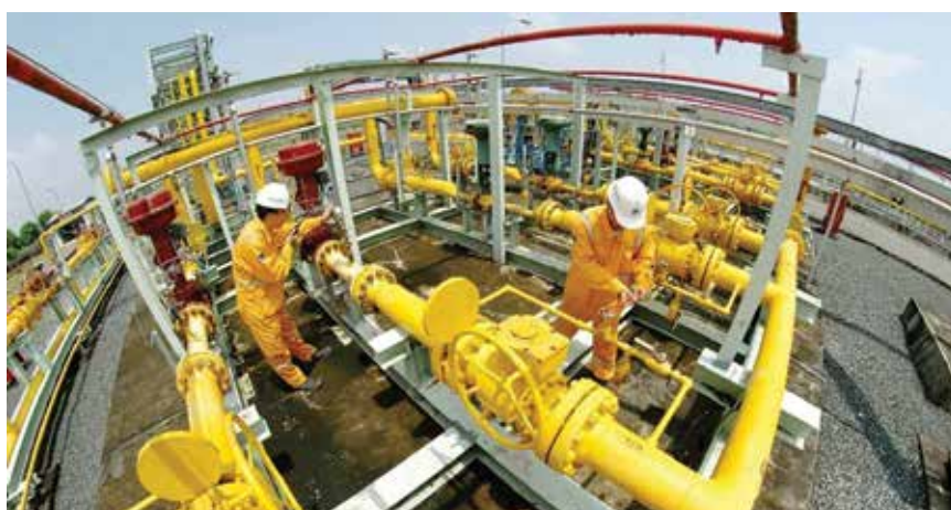
Hệ thống khí của PV GAS vận hành an toàn, ổn định. Ảnh: PV GAS
