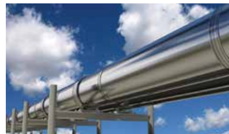
Đường ống dẫn dầu thô và condensate. Nguồn: The Business Journals
