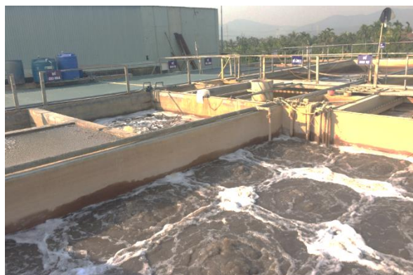
Hình 3.28: Trạm xử lý nước thải Công ty Nhựa thông Quảng Ninh
