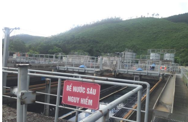
Hình 3.27: Trạm xử lý nước thải Công ty Than Vàng Danh
