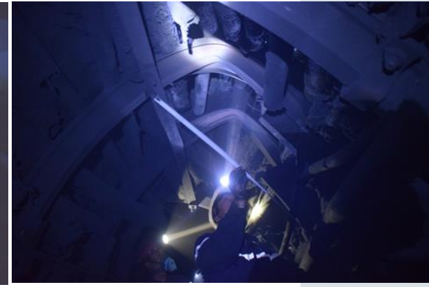
Chân vì chống bị đẩy do áp lực hông
