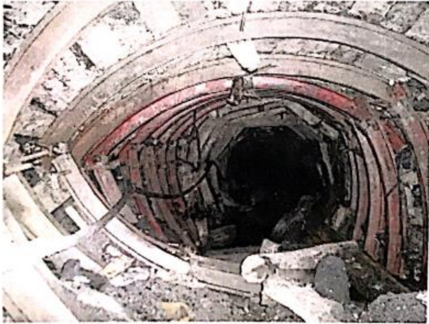
Đường lò xuyên vỉa +17 vị trí PK 348 bị nén lún do áp lực bãi thải
