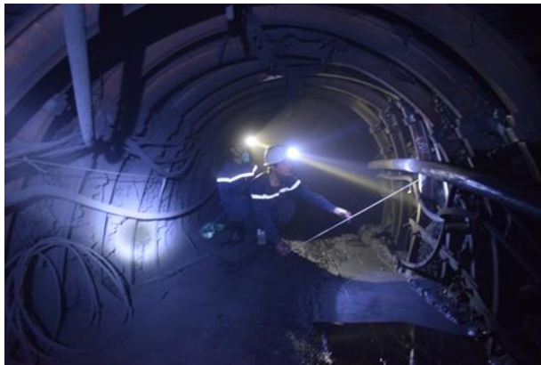
Đoạn lò bị nén bẹp
