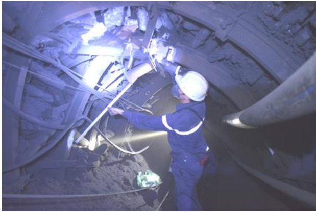
Gông vì chống bị xé do áp lực nóc
