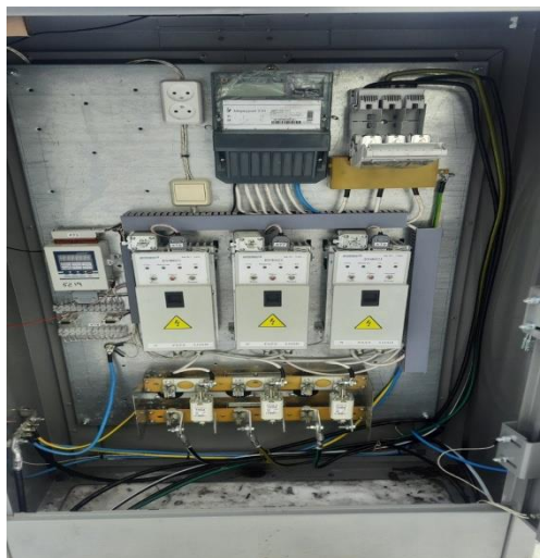
Рисунок 4 – Щит управления, подключенный к АСУНО
