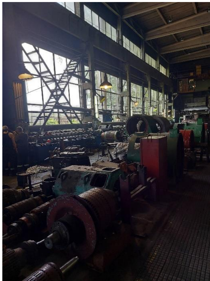
Рисунок 3 – Обмоточный участок по восстановлению обмоток электрических машин
