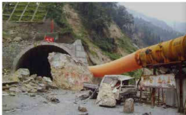
a - Phá hủy cửa hầm phía đông của đường hầm
