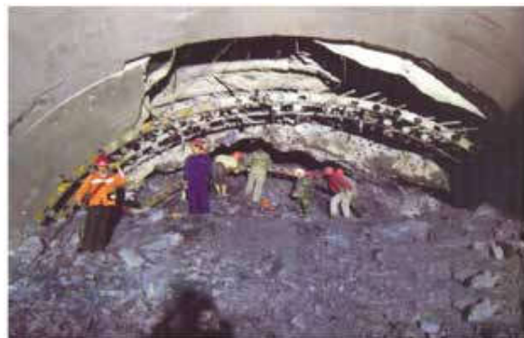
b - Phá hủy vỏ chống đường hầm
