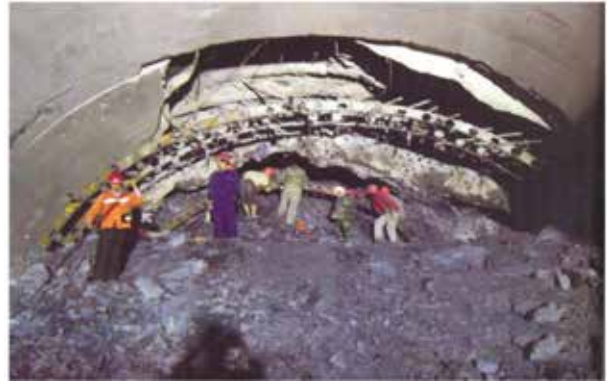
b - Phá hủy vỏ chống đường hầm
