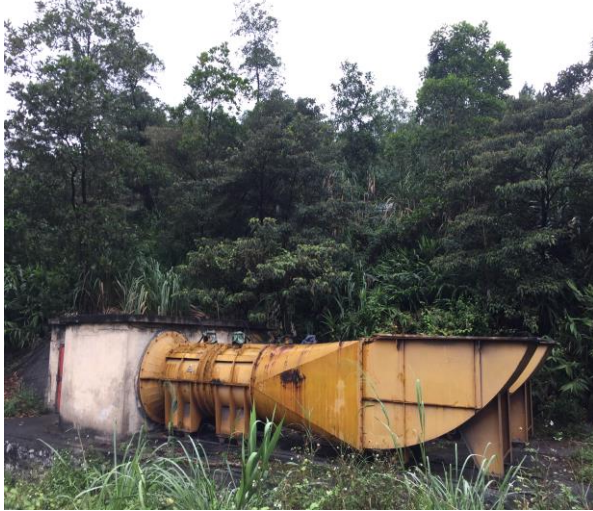
Hình 1: Hình dáng trạm quạt gió chính khu vực mỏ Cao Thắng
