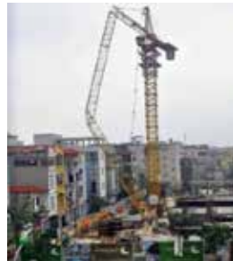
b) cần cầu tháp bị gãy.
